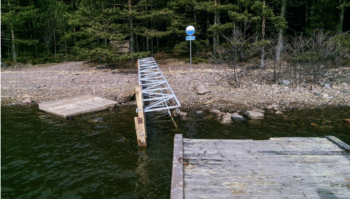
Kuva 2. Seliskerin ison laiturin teräksinen sillake on irronnut ja kyljellään, maatuki on siirtynyt ja sillakkeen puosot ja kiinnikkeet ovat rikkoutuneet.
