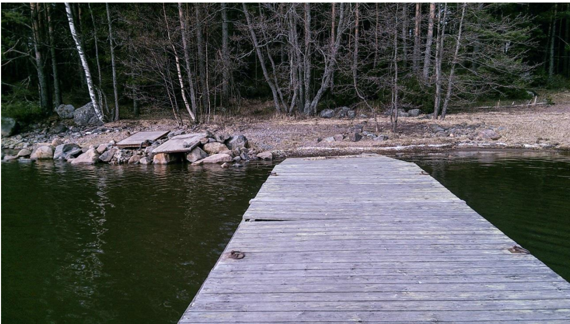
Kuva 3. Seliskerin pienen laiturin kiinnikkeet ovat murtuneet ja laituri on siirtynyt ankkureineen asemapaikaltaan. Sillakkeen oikea sivuniska on murtunut. Sen rannalla oleva kantaosa on paikallaan.
